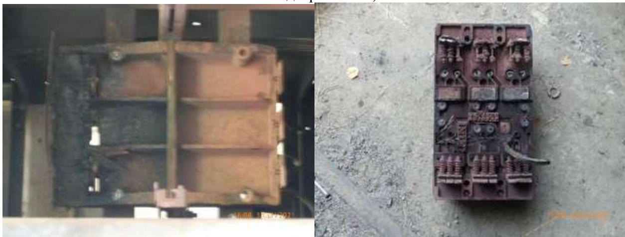
Автоматический выключатель 0,4 кВ, на котором произошло короткое замыкание.
