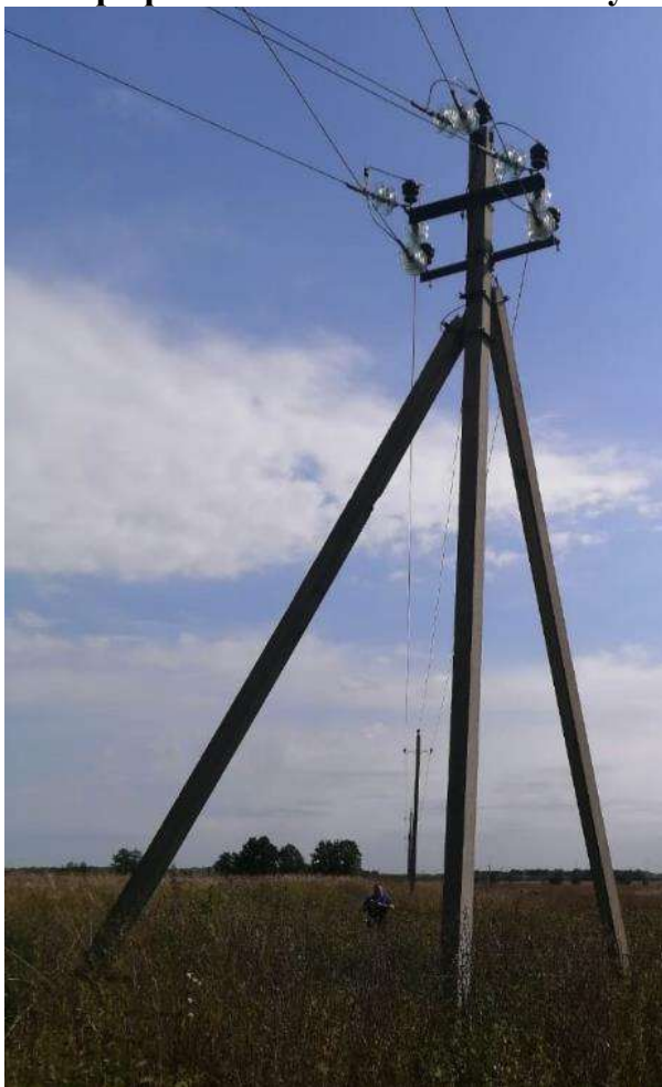
Общий вид места несчастного случая (опора №74 ЛЭП).
