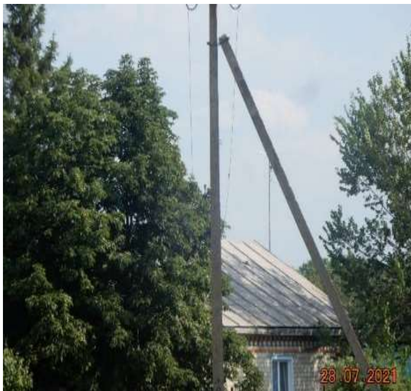
Место несчастного случая, пролет опор №№8-19/20-21 ЛЭП.
