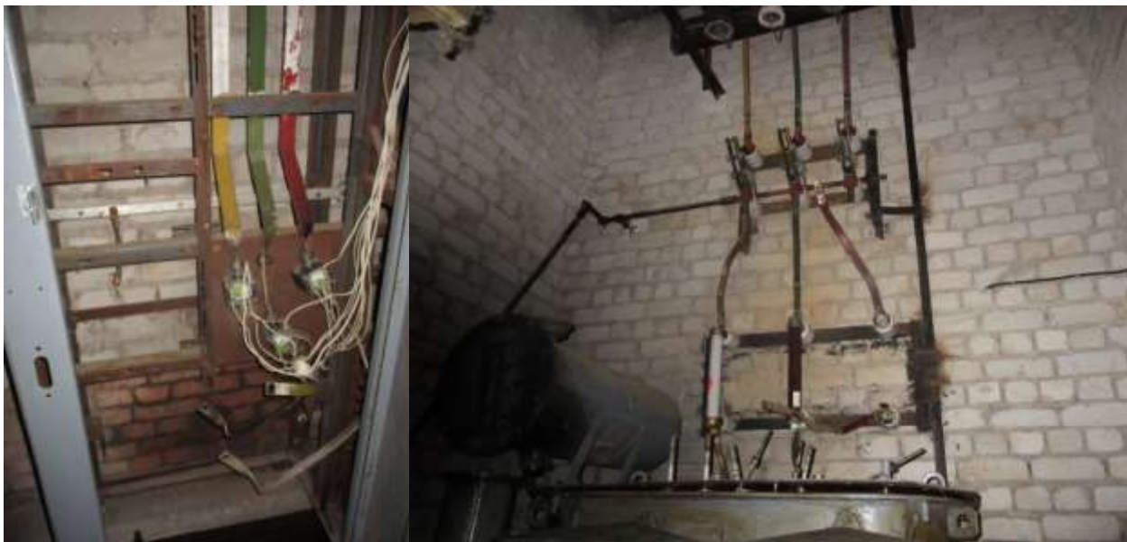
Разобранное оборудование ТП.
